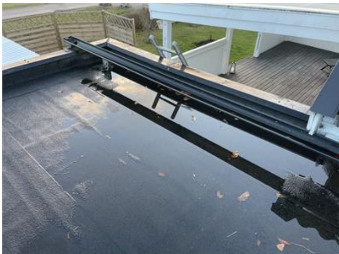
Vatten på garagetak
