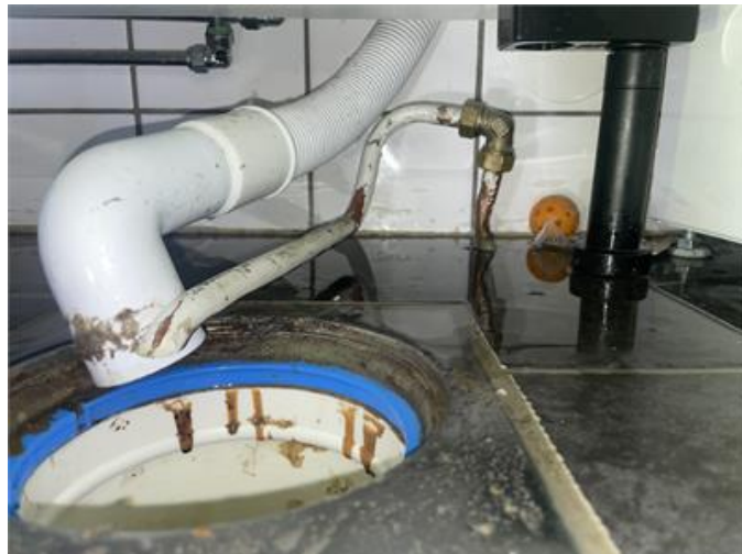
Golvbrunn under skåp i tvättstuga
