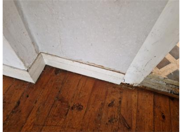
Matrum: Fuktfläckar förekommer på vägg ovan golvssocklar.
