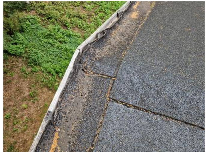
Tak (papp): Takpappen är av äldre standard, har otätheter och vattplåtar saknas.
