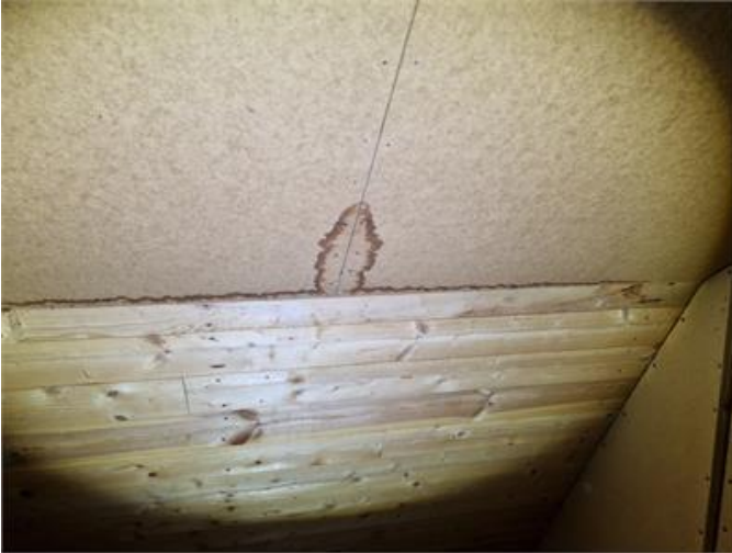
Övre plan/Klädkammare: Fuktfläckar förekommer i tak.
