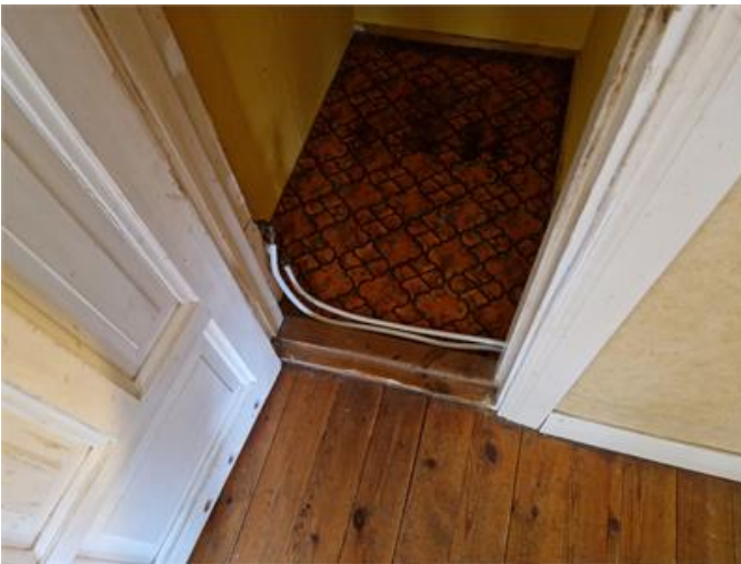
Entréplan/Förråd: Ej fackmannamässigt dragna vattenrör förekommer i utrymmet.
