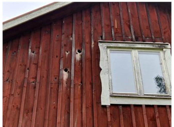
Fasad: Skador/Rötskador förekommer i fasadpanel och syll.
