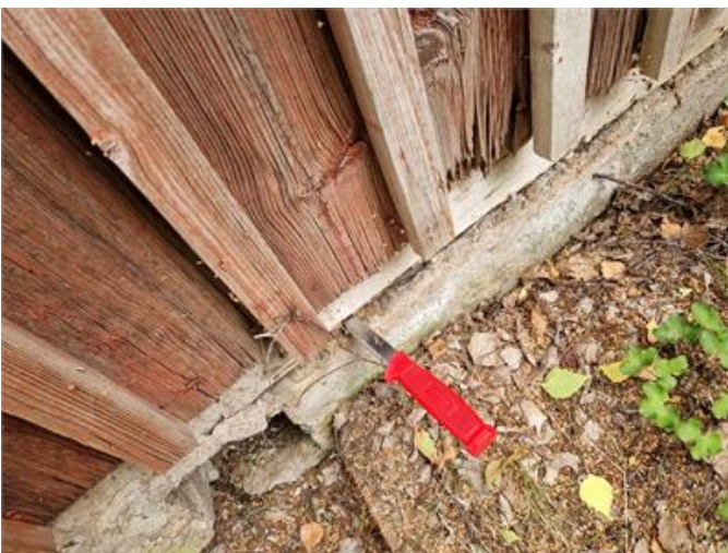
Fasad: Skador/Rötskador förekommer i fasadpanel och syll.
